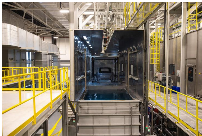
Рисунок 4 -Завод Hyundai Trans Almaty, катафорезно-окрасочный цех
